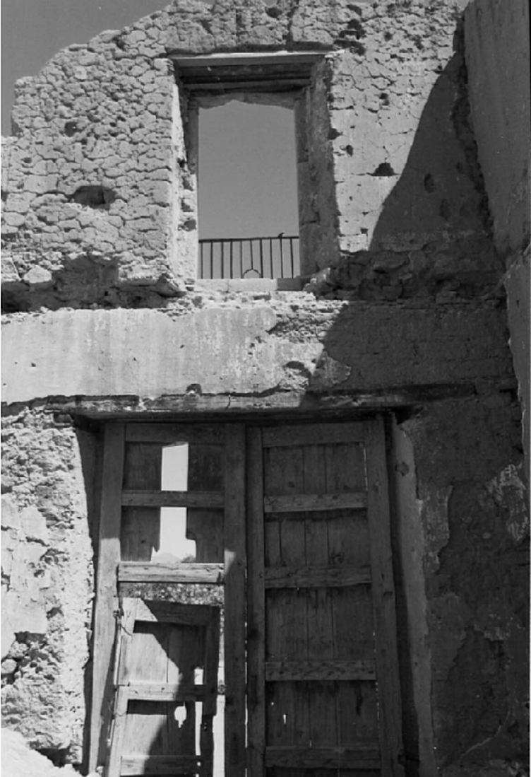
Puerta principal de la hacienda colonial algodonera de Avilés (circa 1808) en la margen izquierda del río Nazas, ciudad Juárez, Durango.
