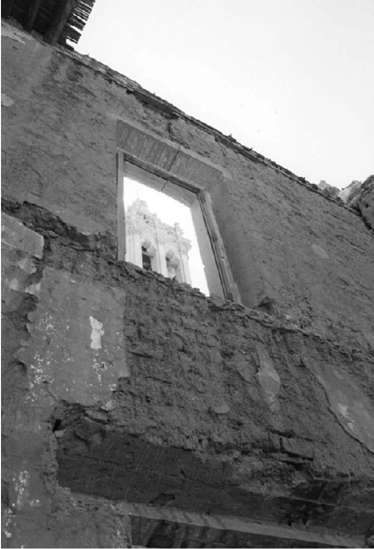
Muro de adobe en los restos de la hacienda colonial algodonera de Avilés (circa 1808) en la margen izquierda del río Nazas, ciudad Juárez, Durango.
